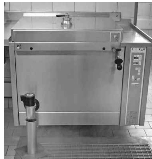
Fig. 4: elementi di sicurezza di una caldaia.
